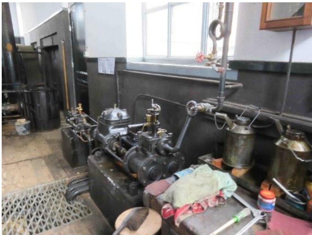
Machines met hete leidingen. Rechts van de duplex condensor koelwaterpompen
